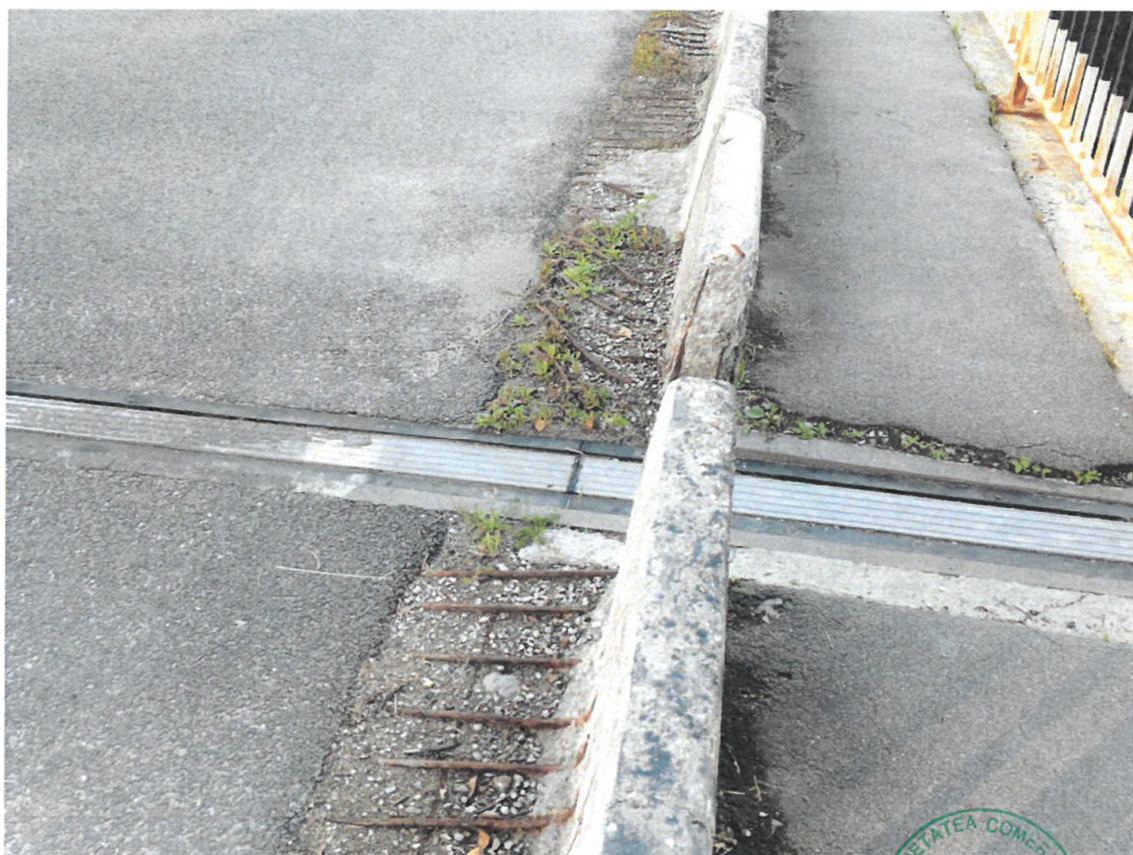
Foto nr. 11 – Degradarea sau dislocarea bordurilor
