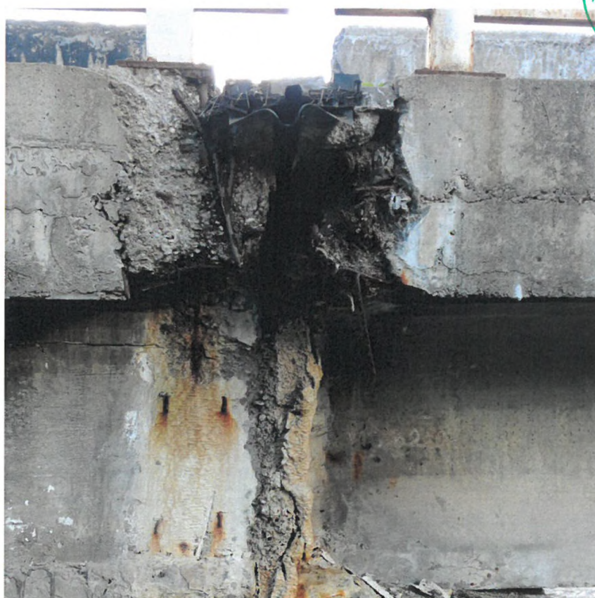
Foto nr. 2 – Beton degradat prin coroziune cu reducerea secțiunii elementului
