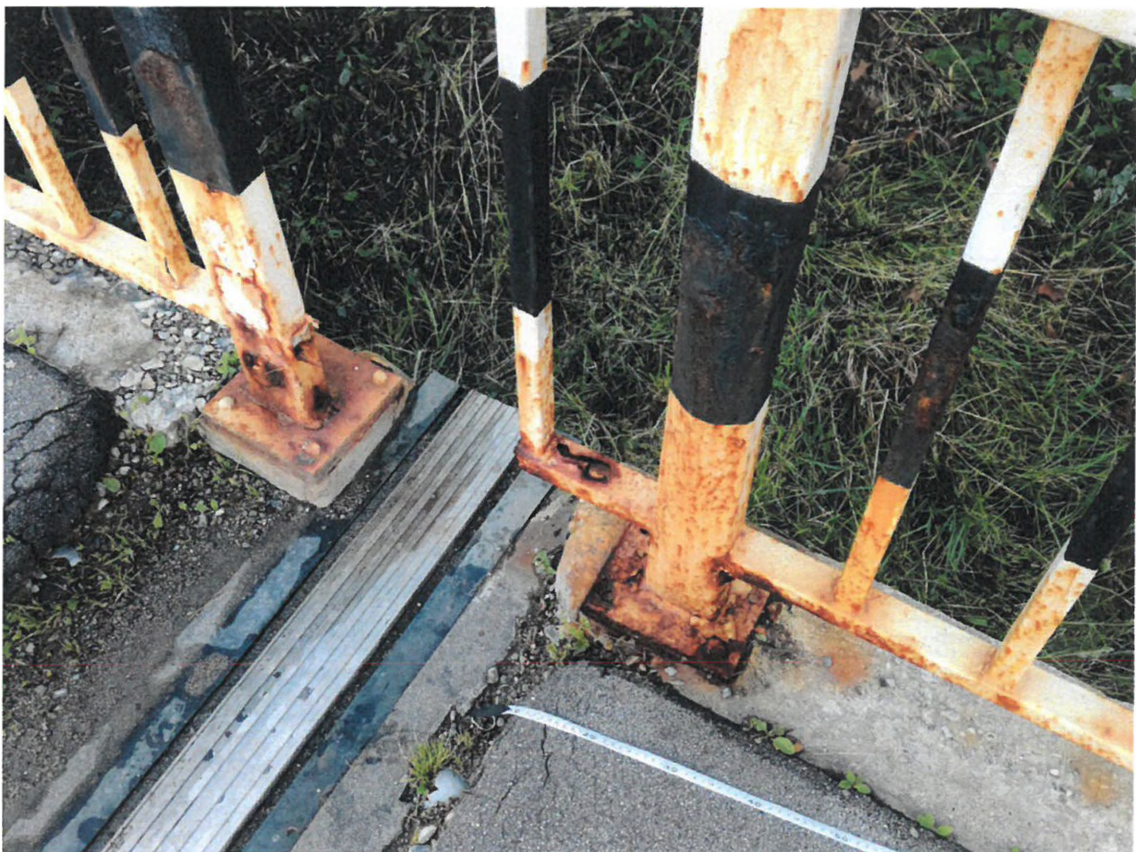
Foto nr. 10 – Coroziunea avansată a stâlpului metalic al parapetului în zona de contact cu betonul, fixarea necorespunzătoare a parapetului de siguranță și/sau număr insuficient de șuruburi de înădire
