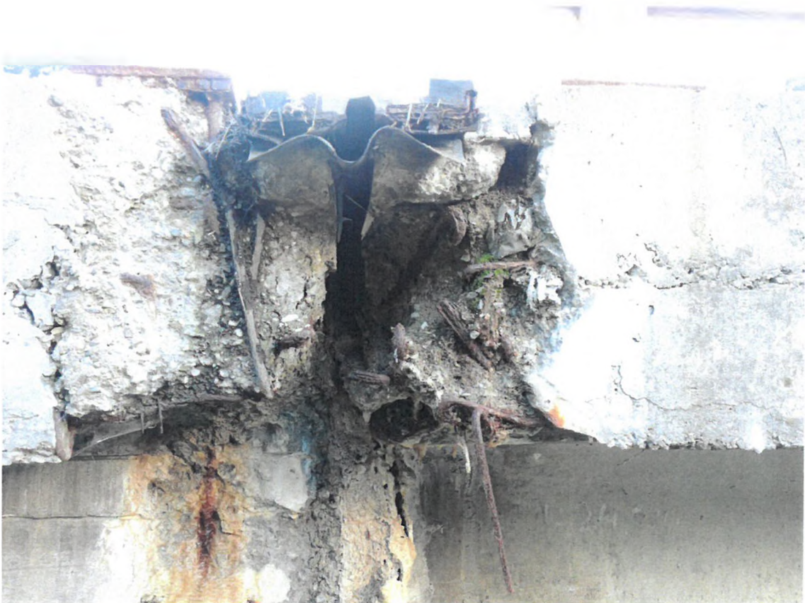
Foto nr. 16 – Degradarea dispozitivului de acoperire a rostului, a dispozitivelor de colectare și evacuare a apei, a elementelor de etanșare, infiltrații în zona rostului
