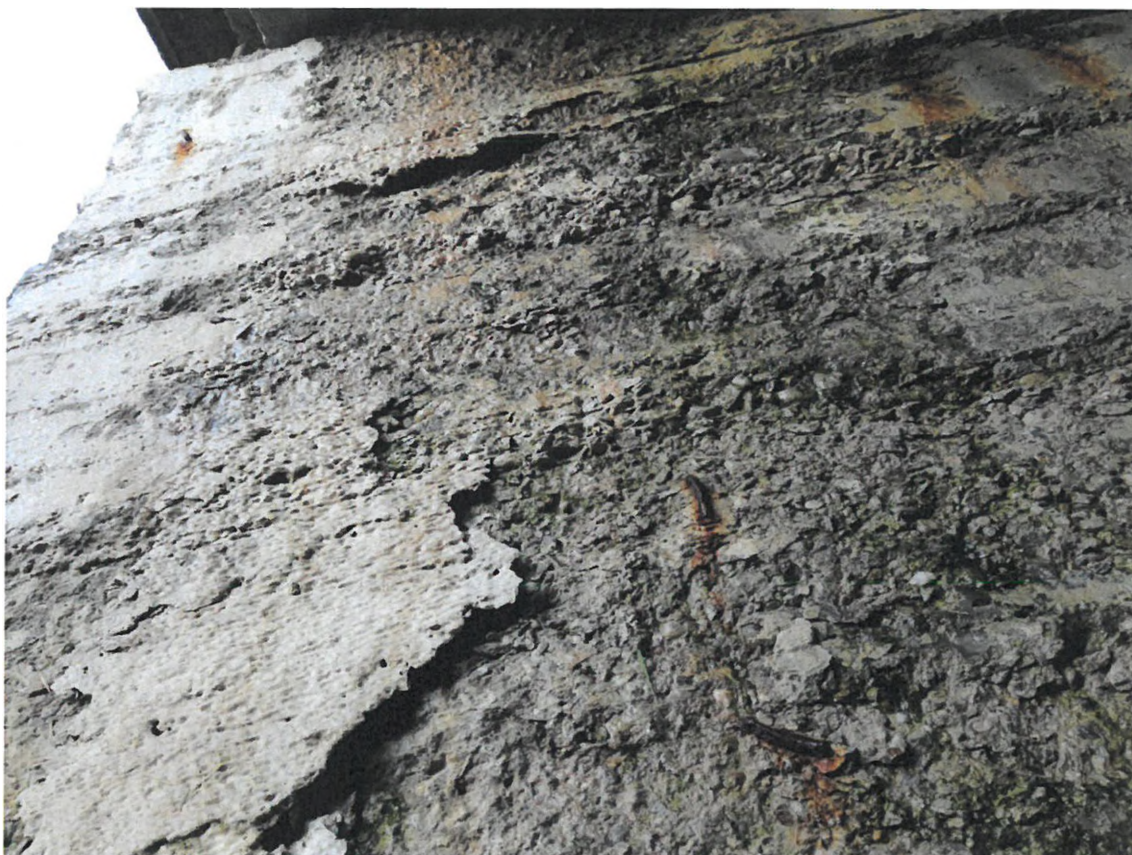
Foto nr. 7 – Beton degradat prin carbonatare, apariția de stalactite și/sau draperii
