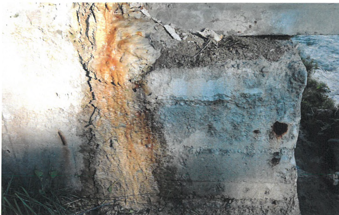
Foto nr. 5 - Aparate de reazem înglobate în praf și murdărie, nefuncționarea corespunzătoare a acestora
