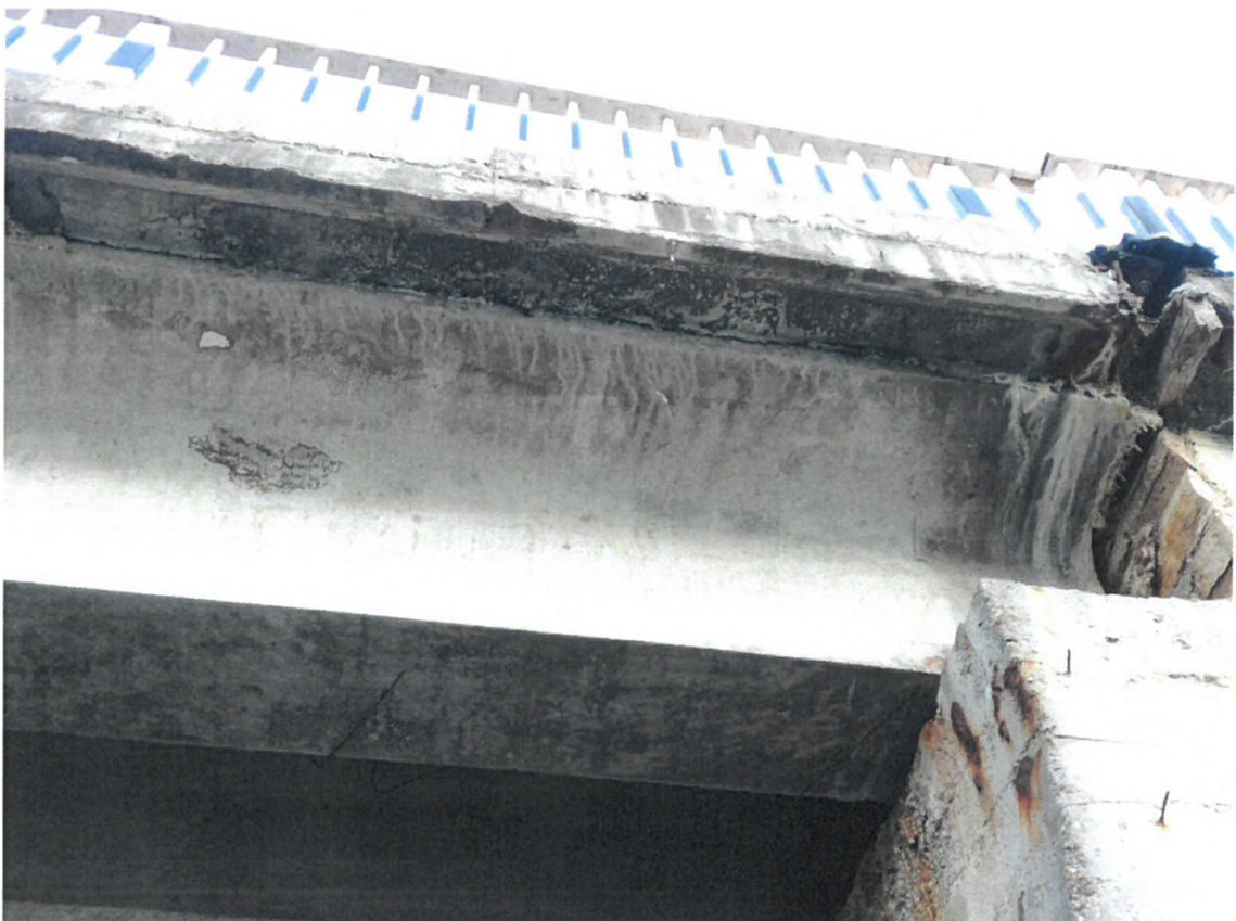
Foto nr. 4 – Infiltrații, eflorescențe la nivelul grinzii parapetului și la intradosul plăcii
