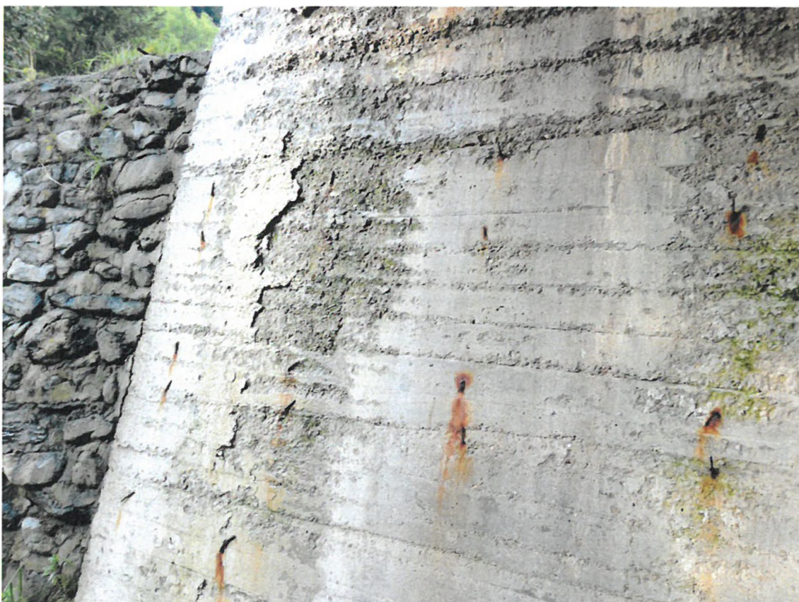
Foto nr. 8 – Cumularea la un element al structurii a mai multor degradări (coroziunea betonului și a armăturii, exfoliere, fisuri, crăpături, striviri) care se manifestă prin modificarea formei elementului și a proprietăților fizico-mecanice ale materialelor
