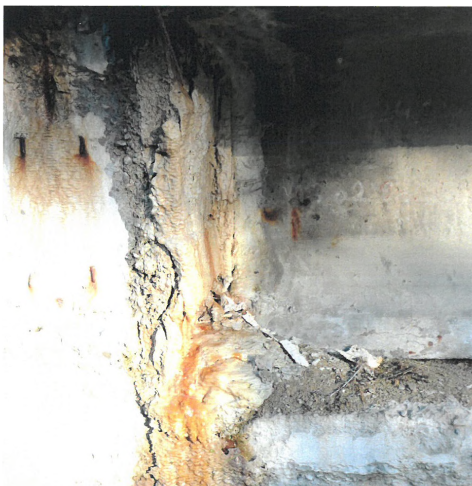
Foto nr. 6 – Blocarea aparatelor de reazem (blocarea deplasării suprastructurii datorită depunerilor și degradării betonului din zidul de gardă)
