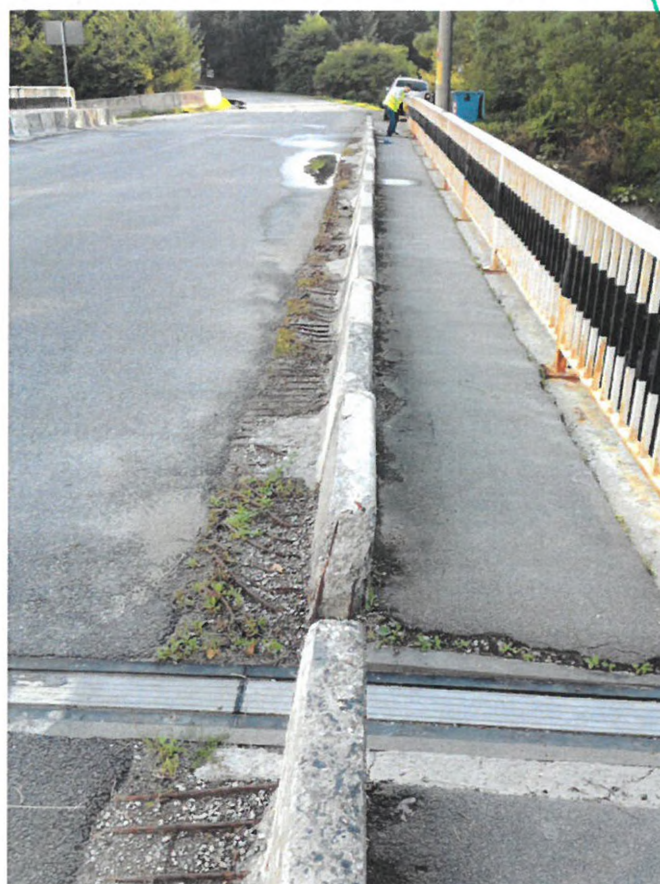
Foto nr. 12 – Denivelări ale căii pe pod, care favorizează sporirea efectului dinamic: văluriri, refulări, fâgașe, praguri, gropi
