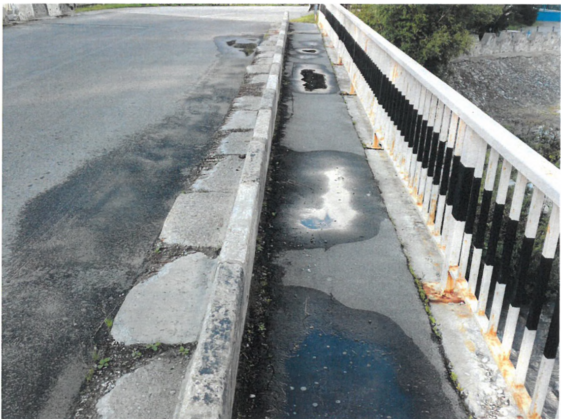
Foto nr. 14 – Neasigurarea pantei de scurgere a apelor pe pod
