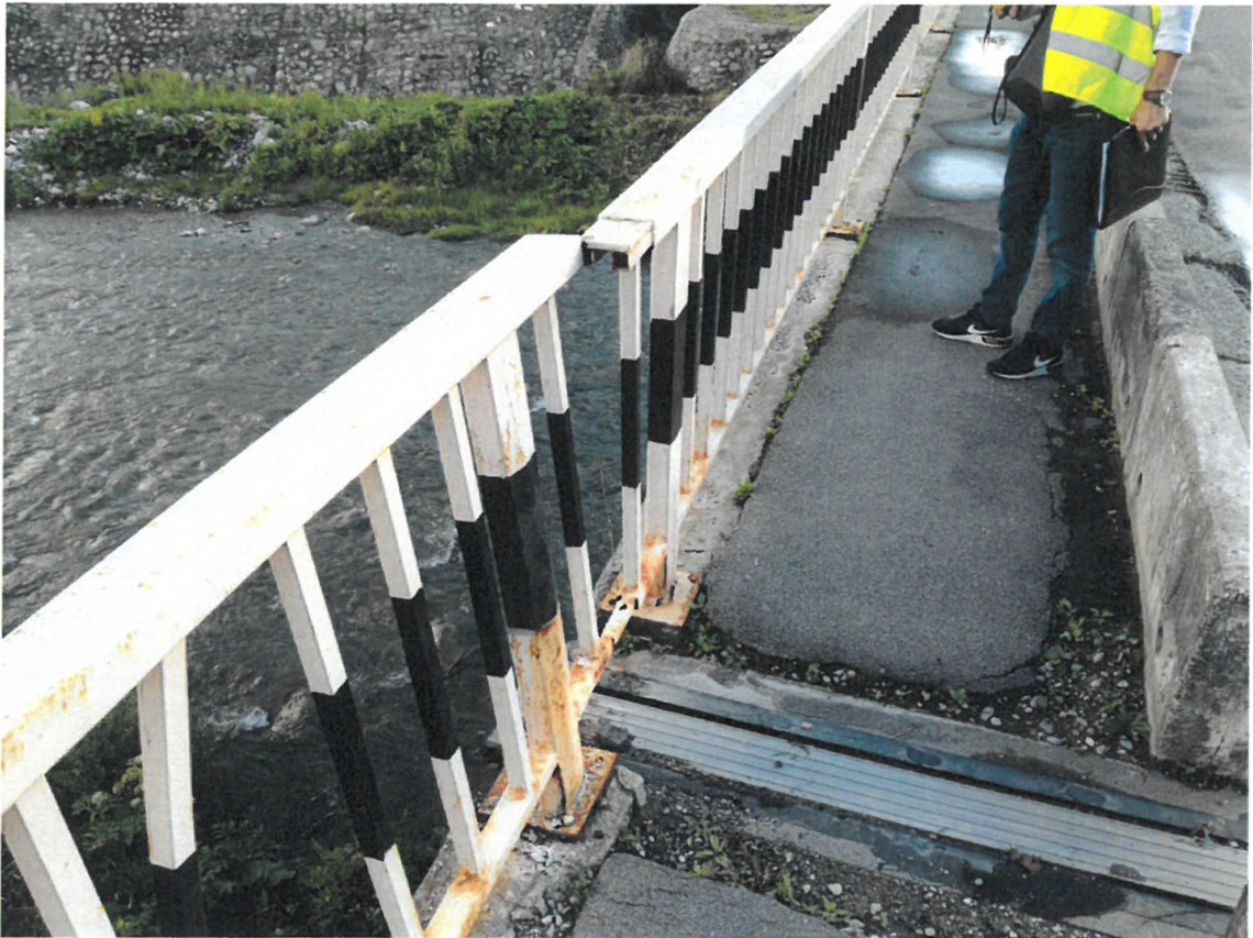
Foto nr. 13 – Parapet cu geometrie generală necorespunzătoare în plan vertical și/sau orizontal, sistem de protecție degradat (mățuit, pete de rugină, exfolieri, etc.)
