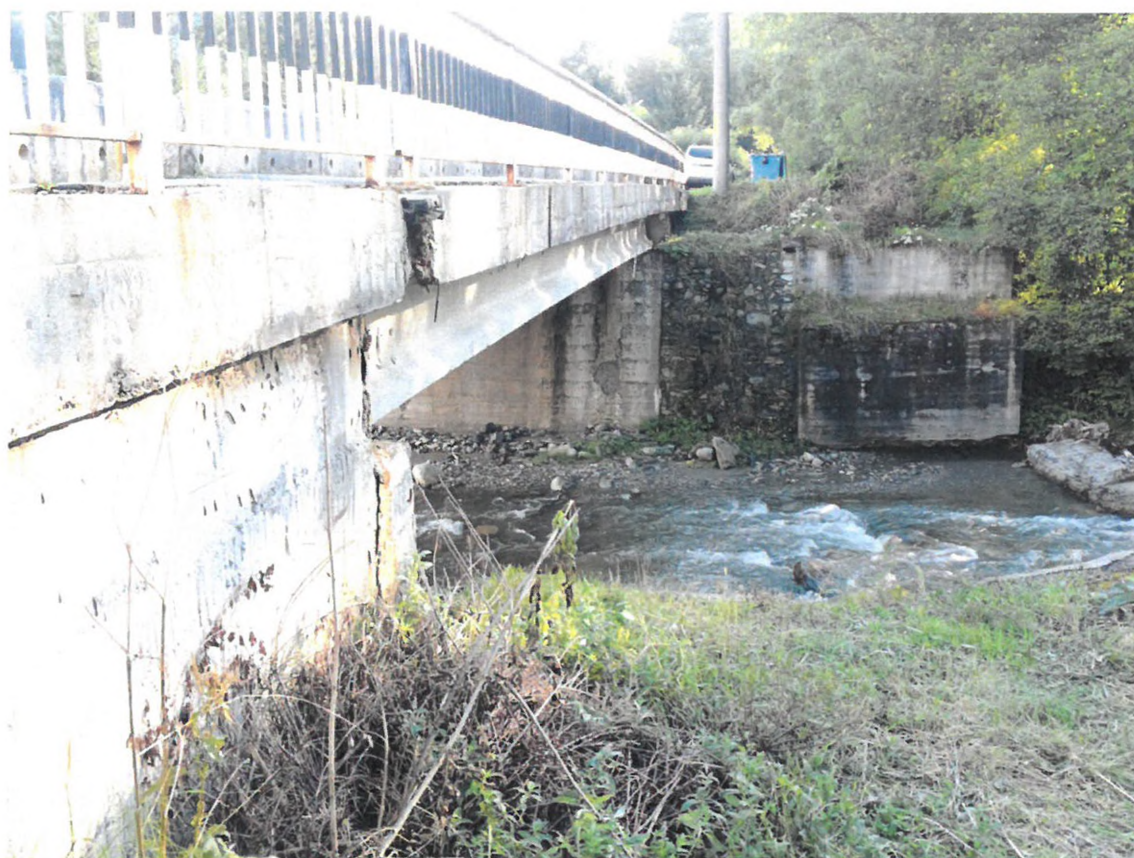
Foto nr. 19 – Modificări ale regimului hidraulic, coborârea etiajului în zona podului, adâncirea talvegului și afuierea zidului de sprijin din beton
